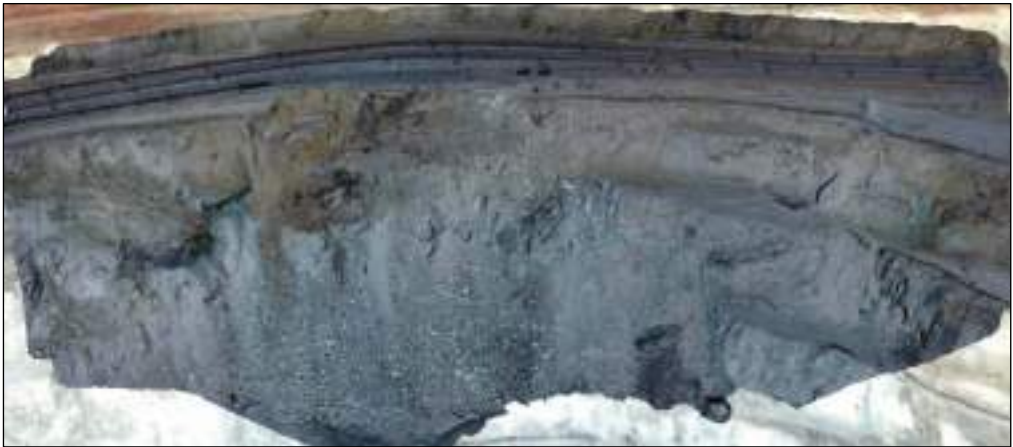
Рис. 1. Нарушенный участок западного борта Кiemбаевского карьера
